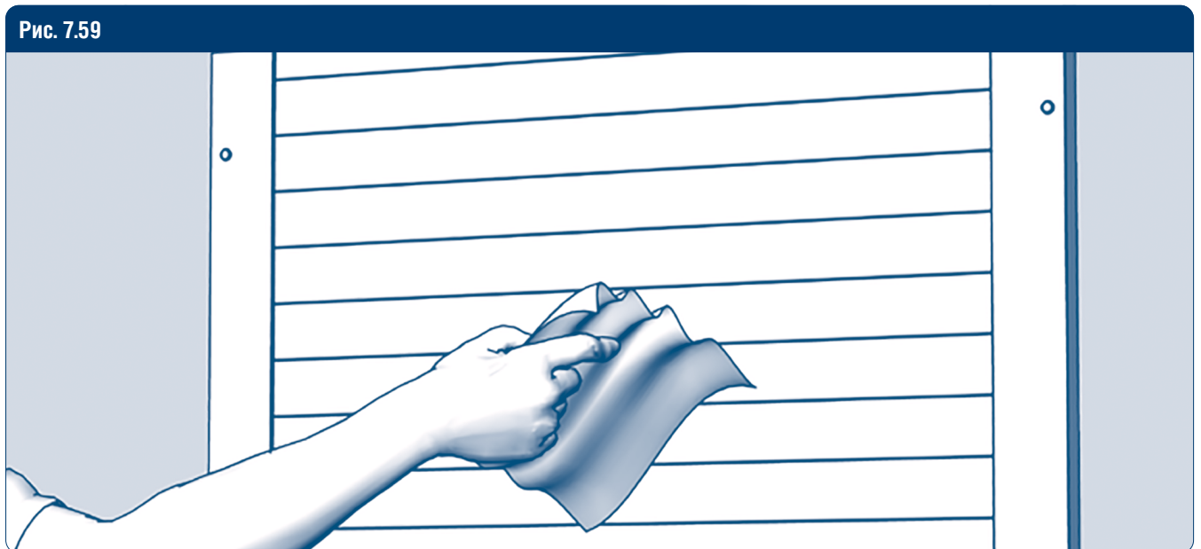
После завершения работ по монтажу роллет и отделке фасада здания удалите защитную пленку с конструкции роллеты. Очистите загрязненные участки.
